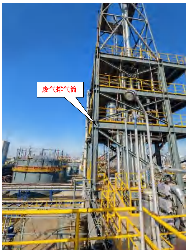
废气治理设施排气筒
