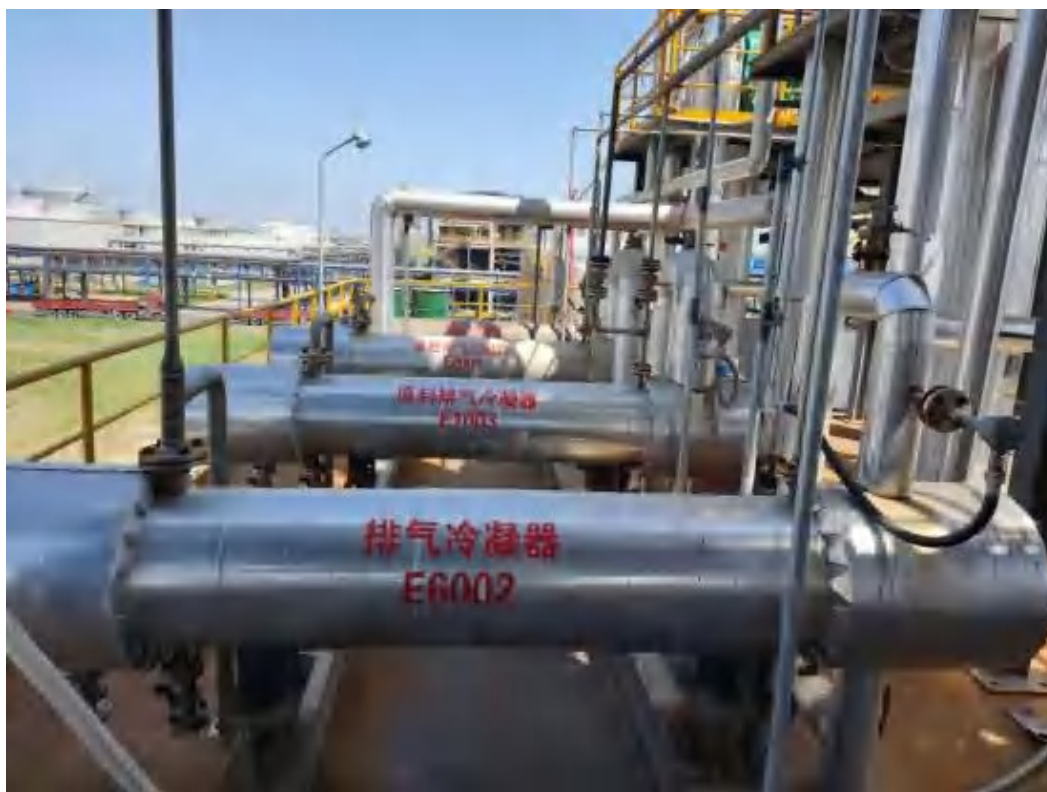
环氧氯丙烷工业化试验废气“-25℃冷冻盐水冷凝”装置
