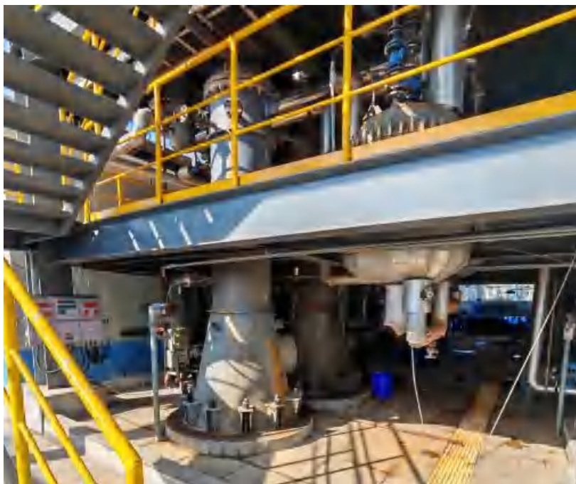
间苯二甲酰氯工业化试验废气“一级水洗+一级碱洗”装置
